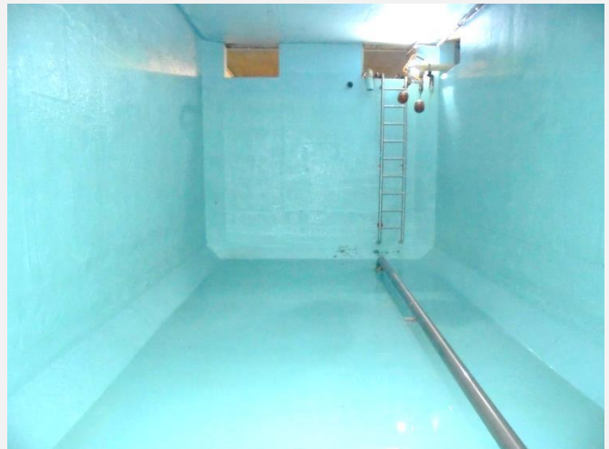
Reservatório após limpeza química e desinfecção
