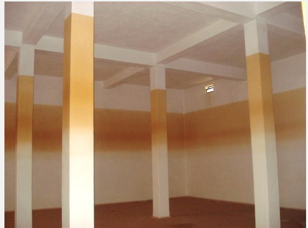
Biofilme visível num reservatório de água
